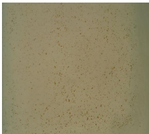
Multiplés points de rouille : vérifier travaux, objets métalliques, pollution ferreuse.
